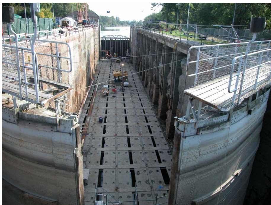
Figur 5. Underhåll av slussarna är ett exempel på förebyggande beredskap och företas vart sjunde till tionde år då fartygstrafiken stoppas i cirka 18 dygn. Foto: Lars Erik Andersson.
